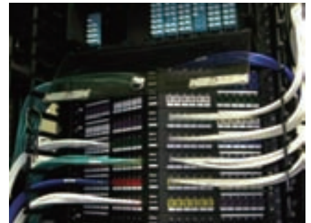
写真 10.1 配線盤（パッチパネル）の例
